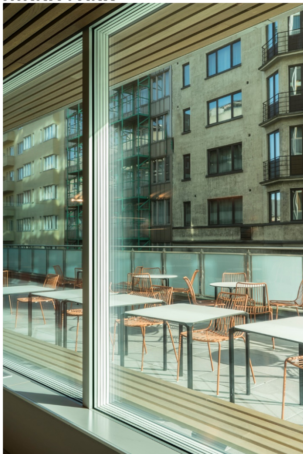
Figur 26 Q-Air integrert i aluminiumsprofil. Plassbygd løsning.
